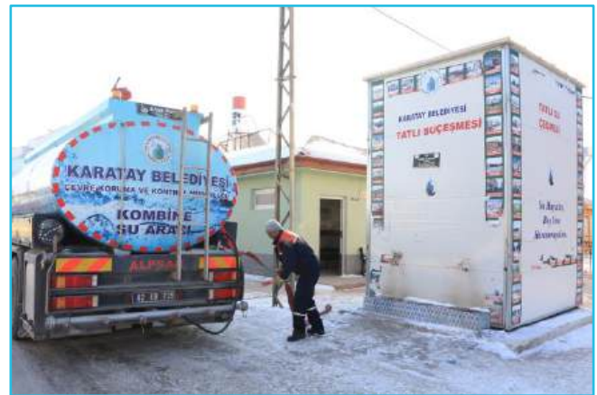
Fotoğraf 42: Tatlı Su Tesisatı Koruması
