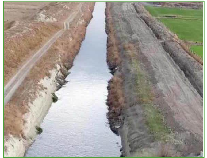
Fotoğraf 18: Tahliye Kanalı Kaynaklı Çevre Kirlilik Risklerinin Analizi
